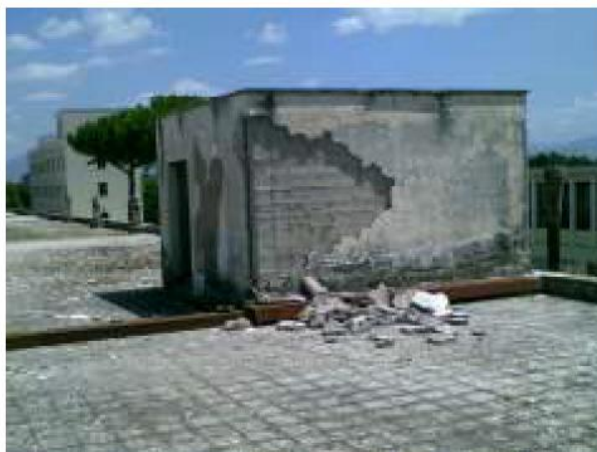
manufatto da eliminare – base 3,1 x 3,1 - altezza 2,1
