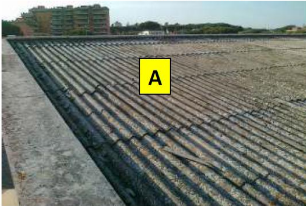
particolare della falda A con amianto da bonificare
