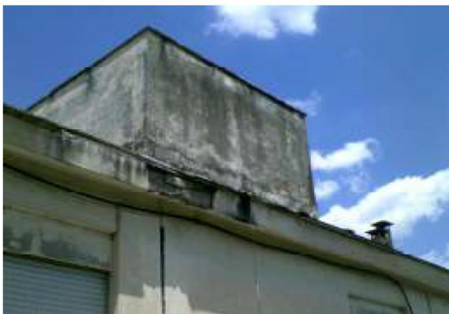
ferro esposto e frontalini da risanare
